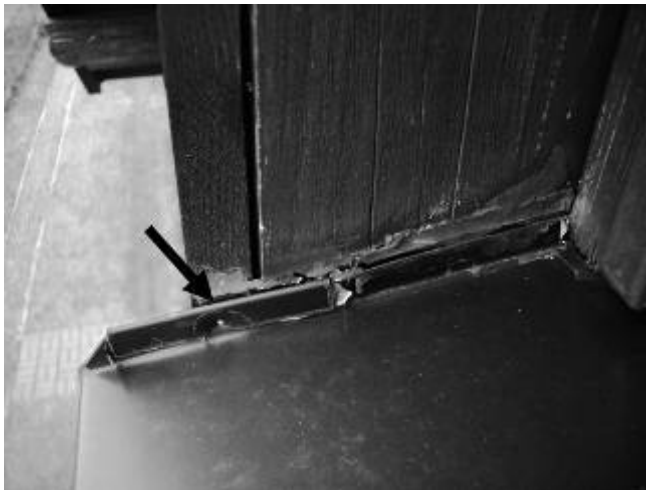
Bild 16: Kohäsionsrisse im Dichtstoff zwischen Metallprofil und Holzwand auf Grund zu starker Fugenbewegung
