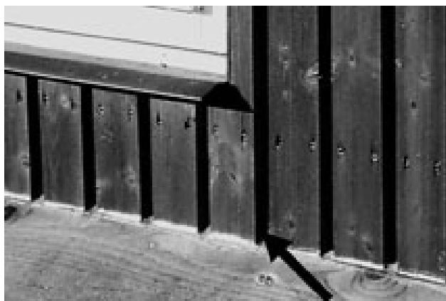
Bild 15: Kohäsionsrisse im Dichtstoff durch zu starke Bewegung der nicht maßhaltigen Holzbauteile
