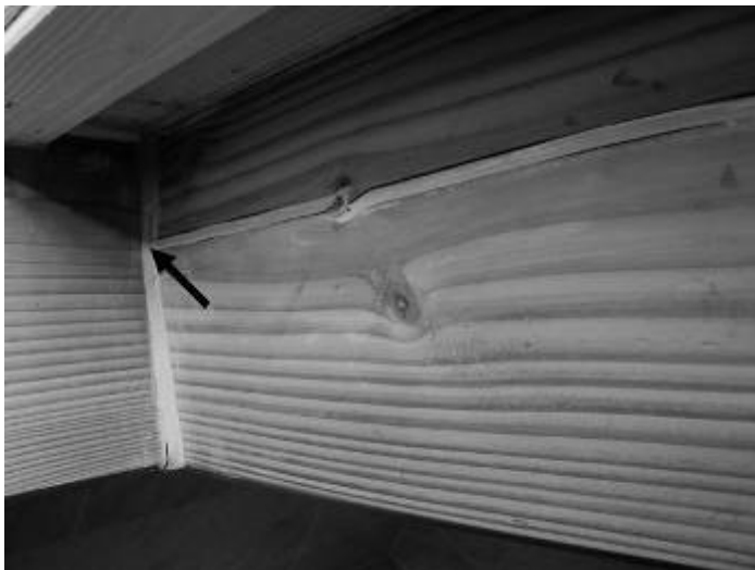
Bild 8: Das Verschließen von Rissen im Holz ist nicht zu empfehlen
