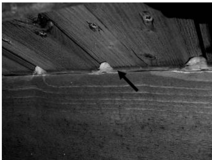
Bild 14: Mangelhafte Fugendimensionierung am Anschluss der Nut- und Federbretter zum unteren Holzbalkenabschluss (nicht maßhaltige Bauteile im Außenbereich dürfen nicht mit spritzbaren Dichtstoffen abgedichtet werden)
