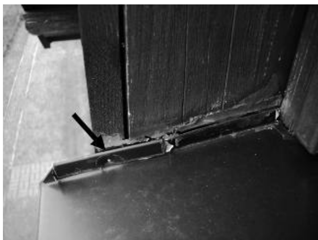
Рис. 16: Трещины сцепления в герметике между металлическим профилем и деревянной стеной на основании слишком сильного движения стыков.
