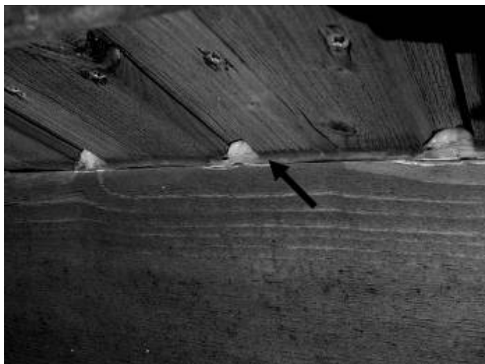
Рис. 14: Неудовлетворительный выбор размеров стыков у соединения досок шпунта и трамплинов к нижнему окончанию деревянной балки (конструкции не стабильных размеров во внешней области не могут уплотняться расплывающимися герметиками).
