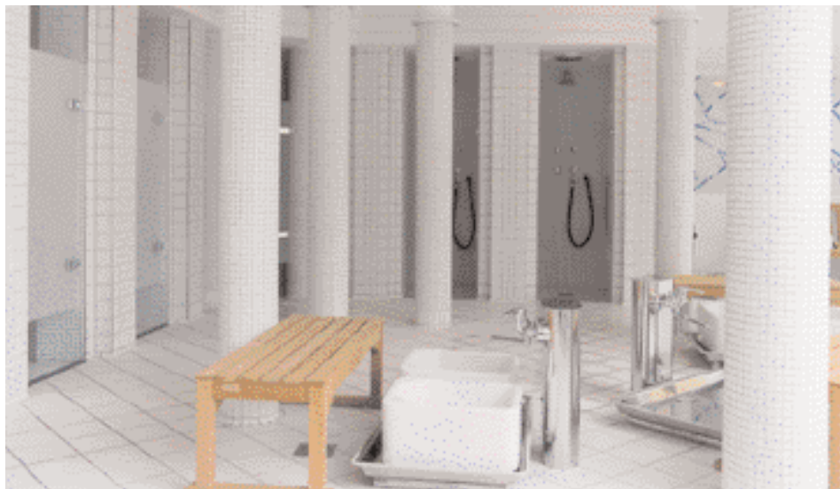
Nur vorschriftsmäßige Verfugung sorgt dafür, daß der Sauna- und Fitneßbereich im Steigenberger Parkhotel frei von Pilz- und Schimmelbefall bleibt.
