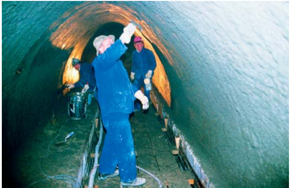
Die Verarbeiter bringen die Dichtschlämme manuell auf, um die Oberflächenrauigkeit zu vermindern.
