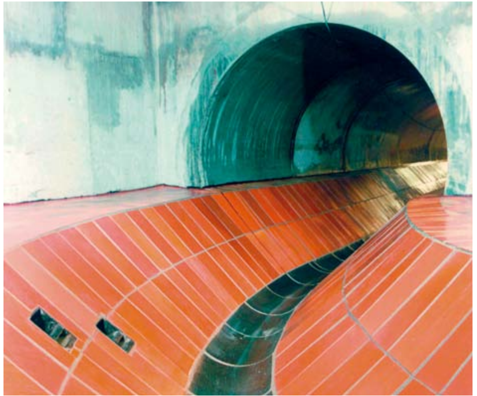
Die zunehmende Aggressivität der Abwässer führt bei Betonkanälen zu Schäden. Sie entstehen in der Hauptsache durch chemische Reaktionen, die bei Betonbauwerken bis zur Bewehrung reichen können.
